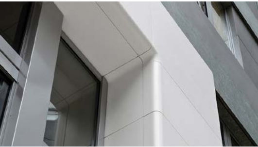
Dass hier HIMACS zum Einsatz kam, war der Tatsache zu verdanken, dass man mit diesem Material perfekt „weiche“ Formen, z.B. abgerundete Ecken gestalten kann.
